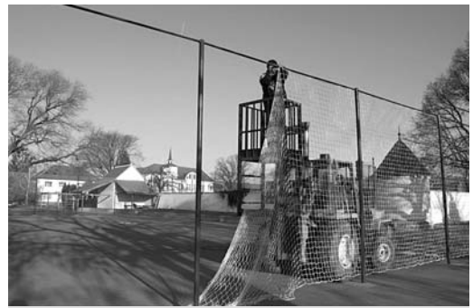
Zaměstnanci Služeb města při instalaci ochranných sítí na hřišti za kostelem Foto: Ing. Zdeněk Karber
